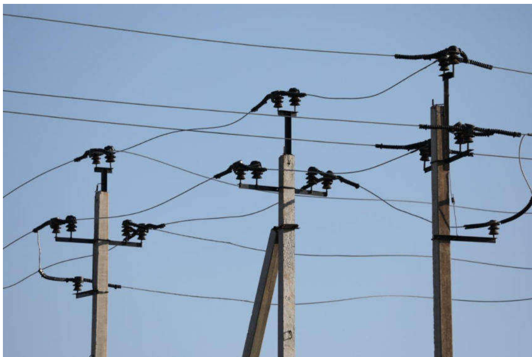
Рисунок 3-39. Опора ЛЭП с ПЗУ (Пашкинский ЛУ)
